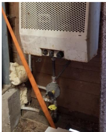
Gasafsluiter Driving Range
